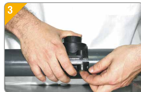
3. Colocar la tuerca en el lugar destinado para facilitarnos la operación del roscado.
